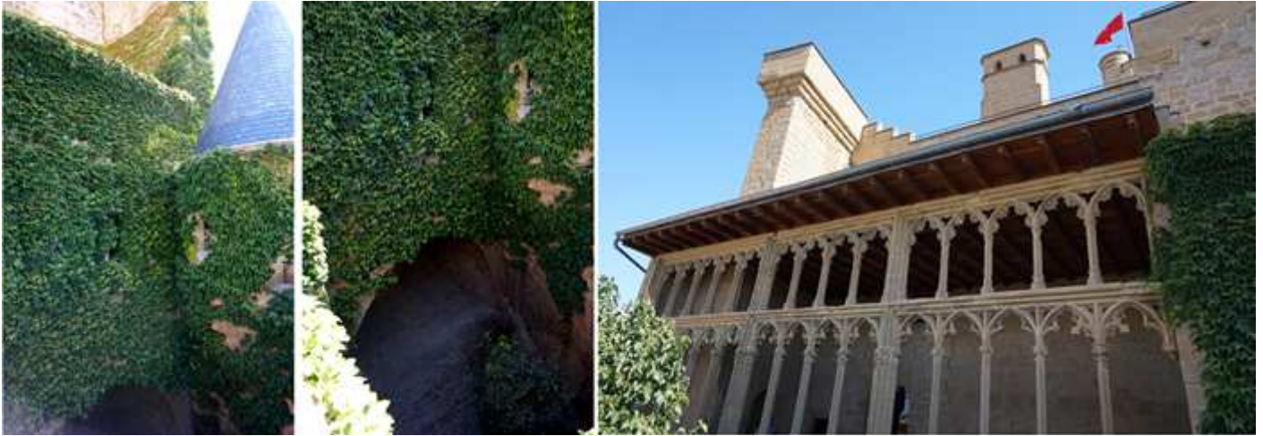
❶ Muros cubiertos de vegetación desde la parte superior del patio de la Morera. ❷ Y que continúan hacia la Galería del Rey. ❸ Esta galería provista de tres tramos con dos pisos de arcos góticos.
