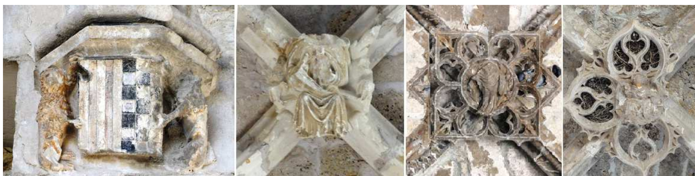
❶ Escudo dividido de los palos de Aragón y el ajedrezado de Urgel, armas de los condes de la tercera dinastía. ❷ Clave con ¿? Posible Cristo en majestad. ❸ Otra clave con tracería gótica. ❹ Y esta con distinta forma la tracería y en su interior Cristo sedente.
